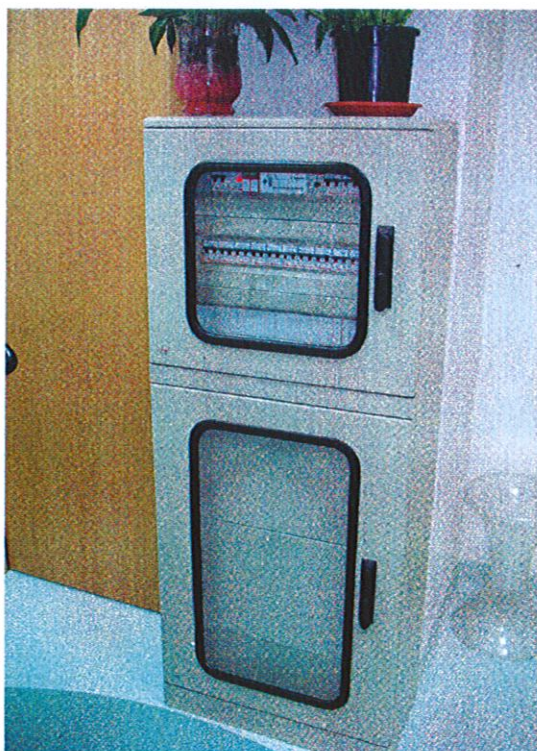
A sinistra: la sala di sterilizzazione; a destra: il quadro elettrico delle due sale odontoiatriche
