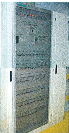
Figura 9 - Quadro di reparto (radiodiagnostica)
