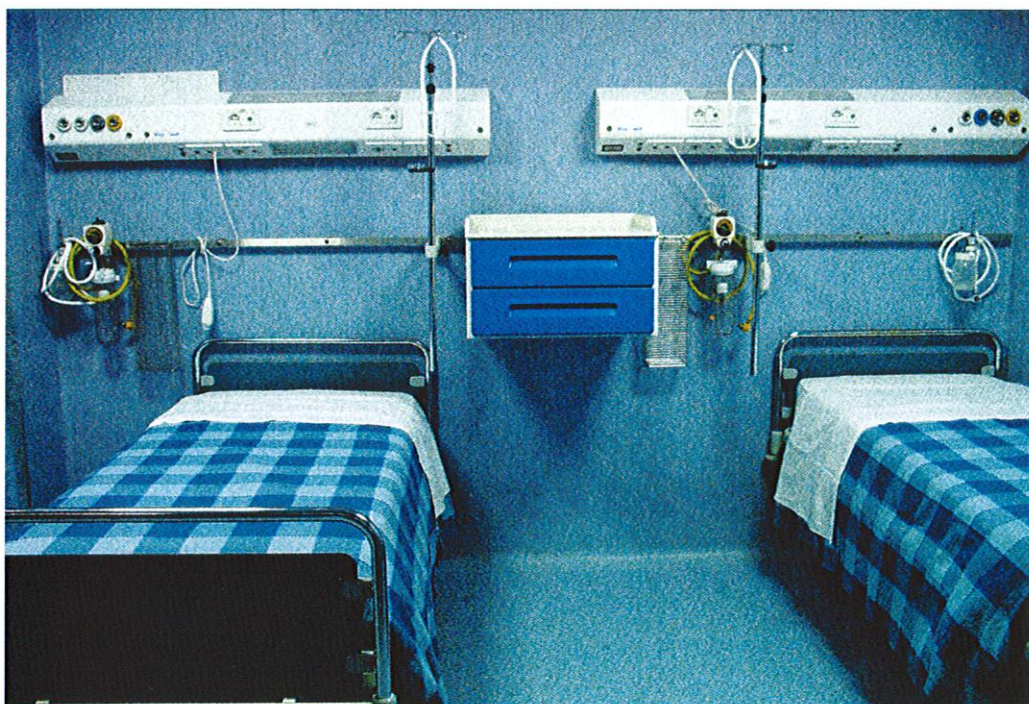
Vista della sala di preanestesia/risveglio
