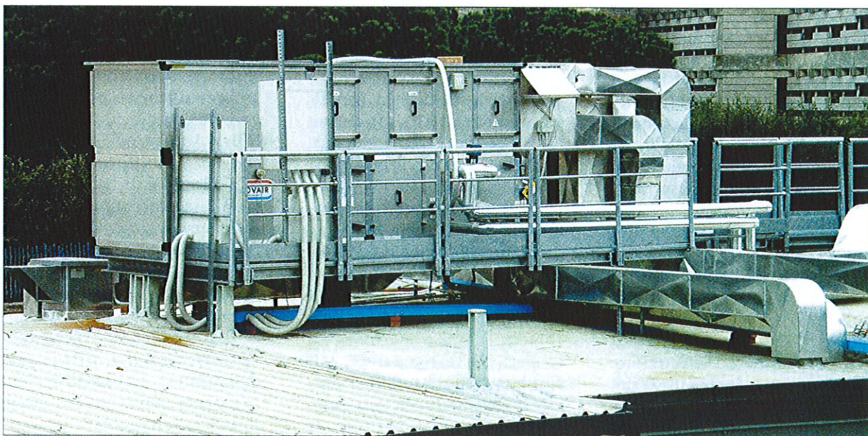
L'Uta è stata installata sul solaio di copertura dello stabile
