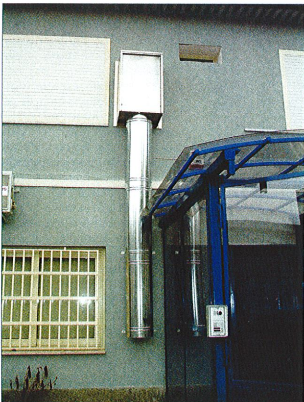
Nel locale "sporco" il materiale proveniente dalle sale operatorie viene inserito in appositi "cestelli passa-sporco" in acciaio inox e passa direttamente in esso, venendo allontanato attraverso un'opportuna "tramoggia" all'esterno dell'edificio
