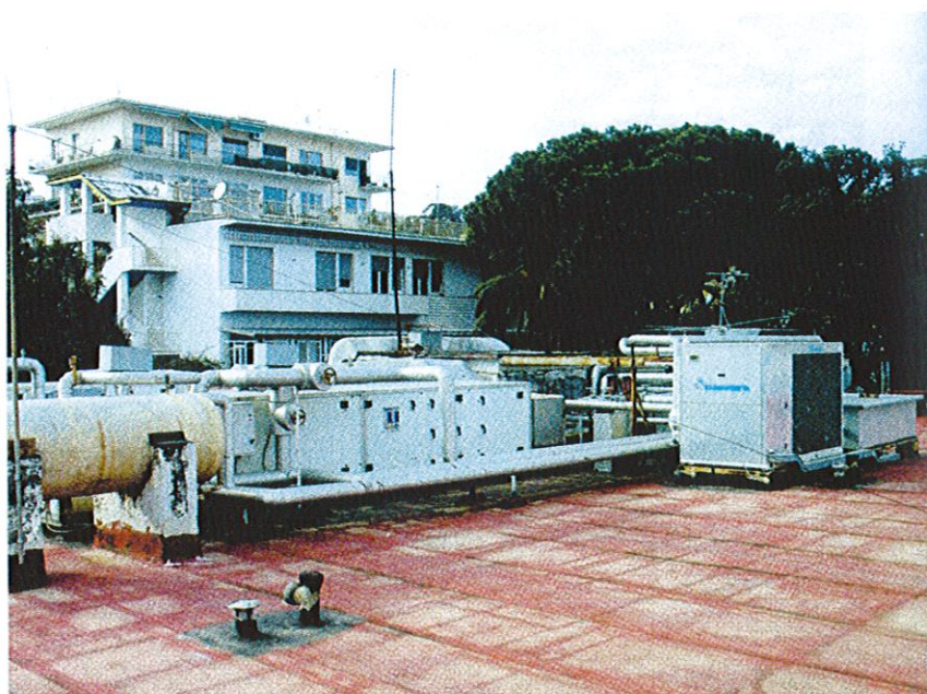
L'Uta è equipaggiata con prefiltri, filtri a fasce e filtri assoluti ad alta efficienza, conferendo all'aria immessa negli ambienti un grado di purezza che garantisca la loro massima sterilità
