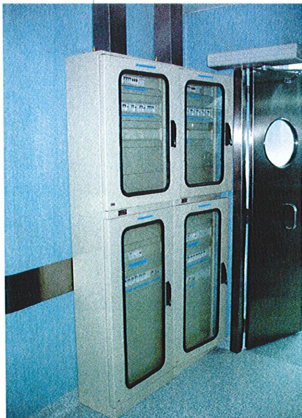
Le sale operatorie e la sala preanestesia/risveglio sono alimentate mediante un proprio quadro elettrico
